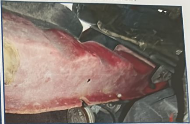
TORRE LADO ESQUERDO OK
